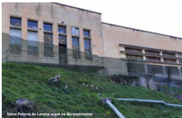
Usine Polonia de Levens avant sa déconstruction
