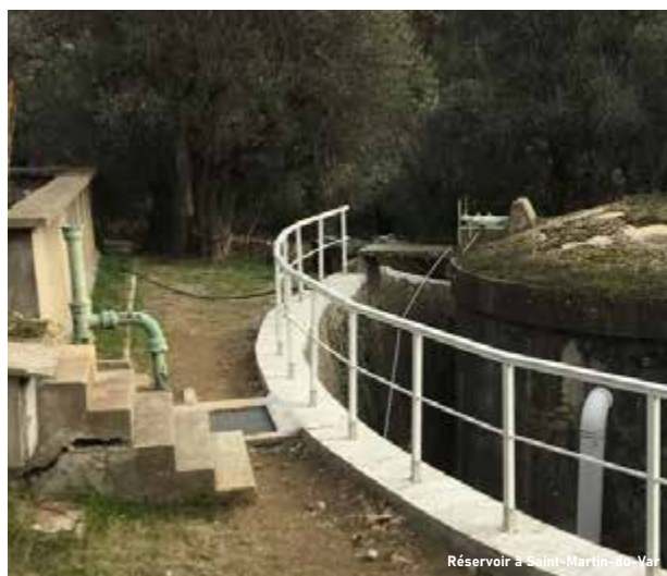
Réservoir à Saint-Martin-du-Var
